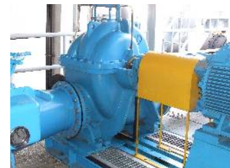
ポンプ逆転水車
