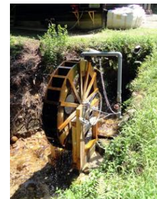
直径1.6m 防災ハウスの非常用電源
