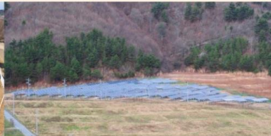
グリーンパーク都路発電所 (449kW)
