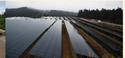
棚倉堂ノ沢発電所 (2678kW)
