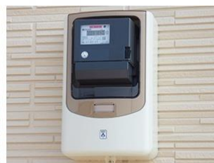
スマートメーター
