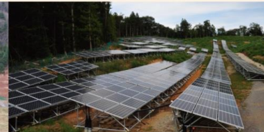
矢吹中丸発電所 (739kW)
