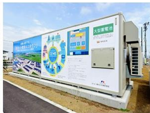
大型蓄電池 (480kWh)
