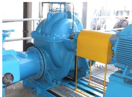
ポンプ逆転水車
