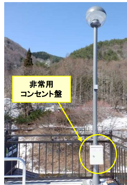
写真 外灯ポールに設置した非常用コンセント(平常時は施錠)
